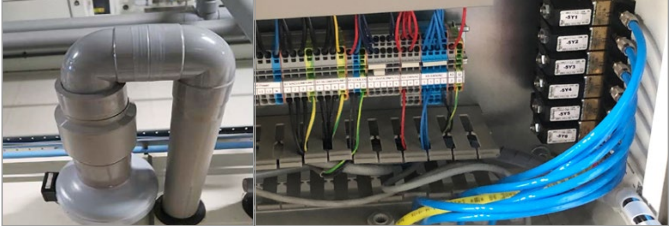
Anstatt die Adsorberrohre für die Messung und die Zwangsbelüftung zu nutzen, sind die neuen Systeme mit einem Messschlauch (Rechts) und einem Belüftungsventilator (Links) für jeden CA-Raum ausgerüstet.
